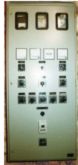
Cuadro de la instalación eléctrica (1979) cuando aún estaba en el interior de la Torre
