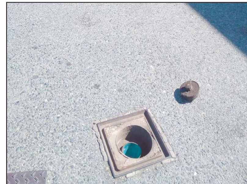
Fotografía 6. Vista del piezómetro S-B existente.
