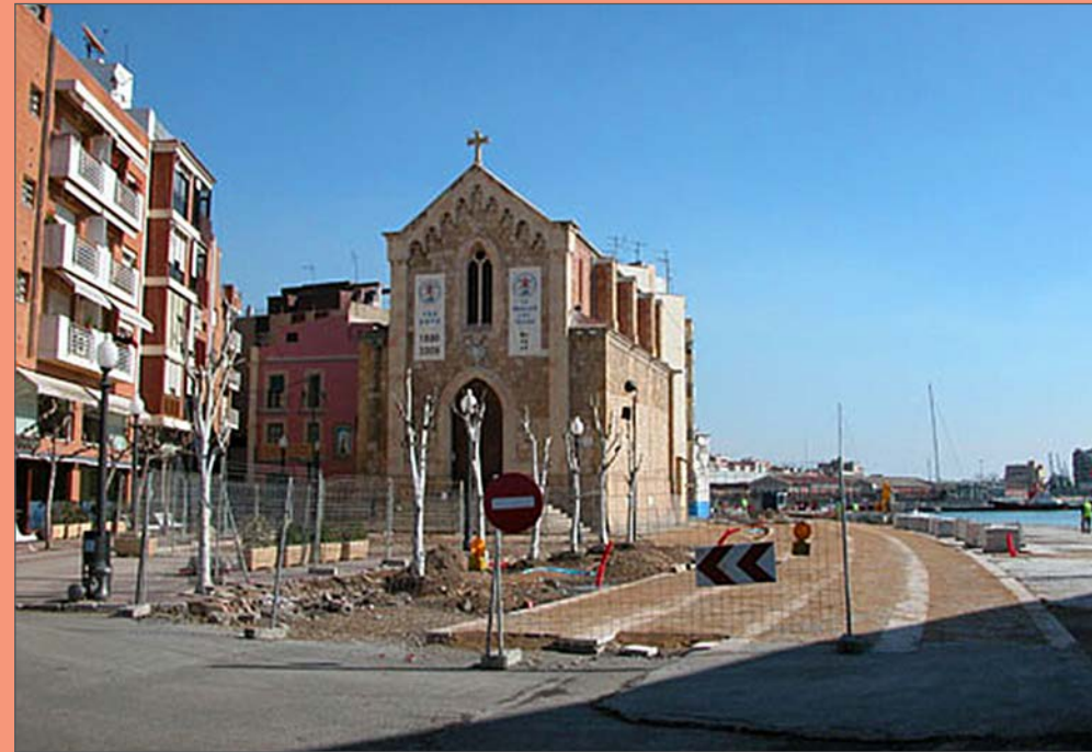
Obres de reforma al Serrallo davant l'església de Sant Pere, l'any 2007. Arxiu del Port de Tarragona. Autor: Manel Caro.
