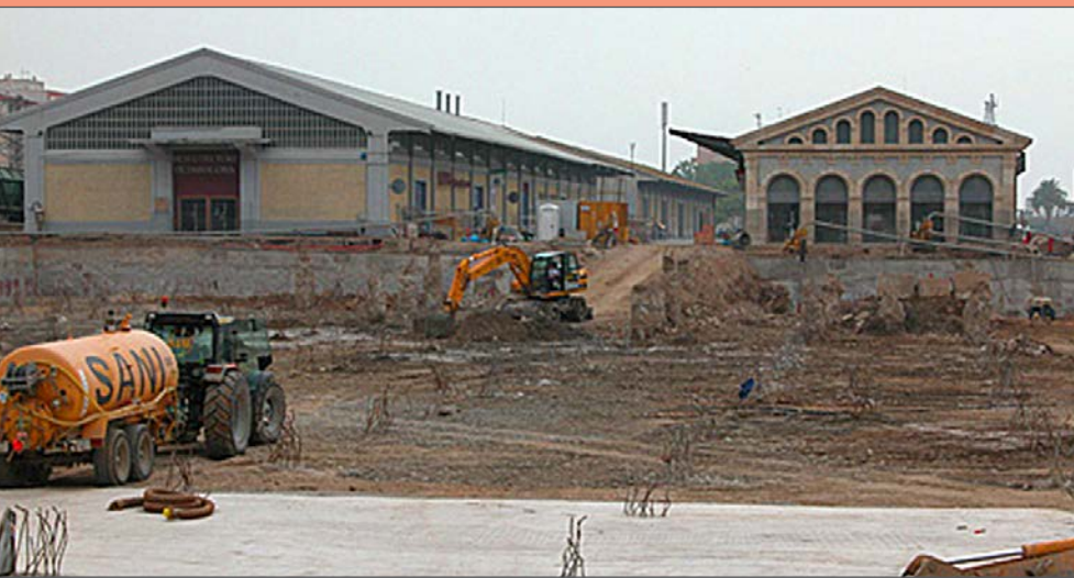
Obres de construcció del pàrquing del Serrallo l'any 2005. Arxiu del Port de Tarragona. Autor: Manel Caro.
